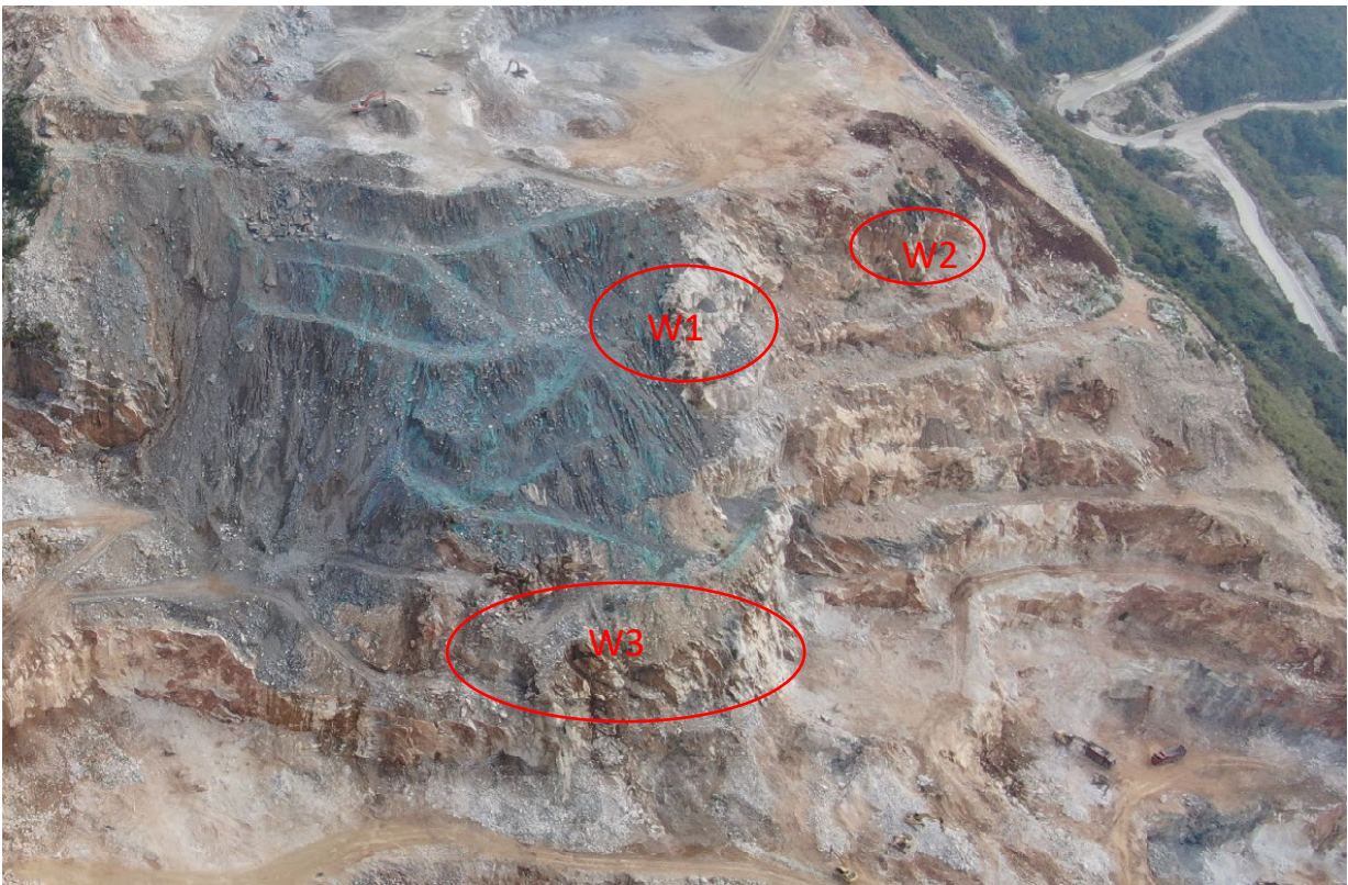
照片 3-2-1 露天采场边坡危岩 W1~W3
